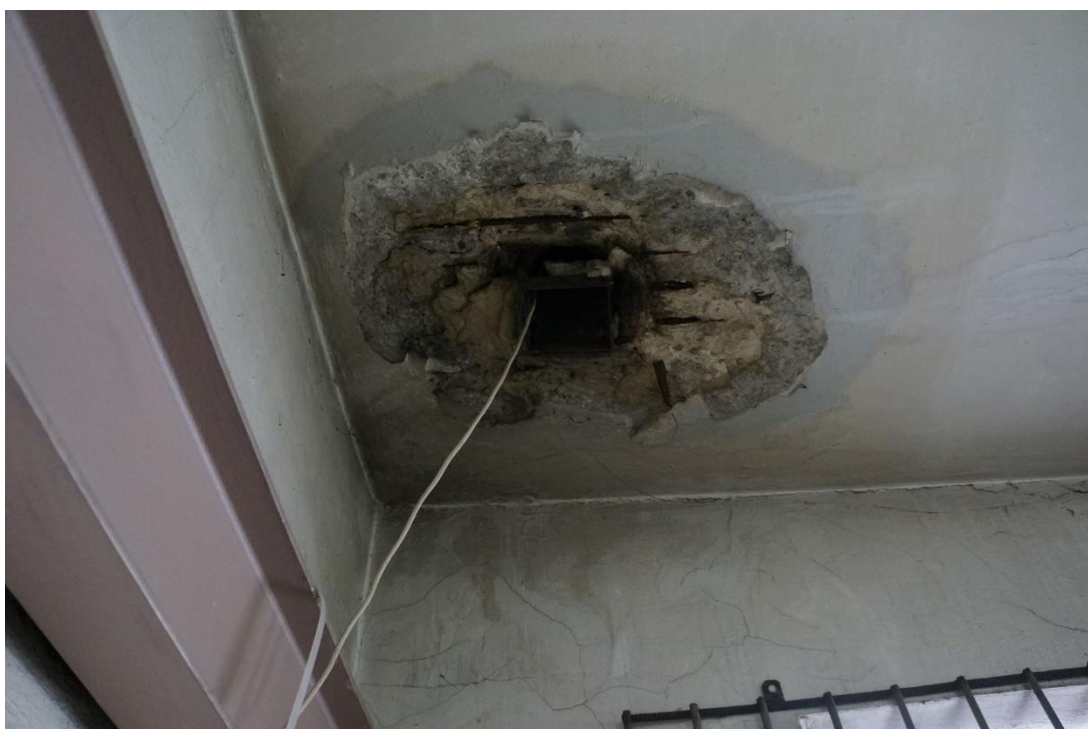
Rysunek 13. Korozja zbrojenia stropu nad maszynownią, brak wypełnienia betonu - - brak bezpośredniego wpływu na prace jednostek dźwigowych
