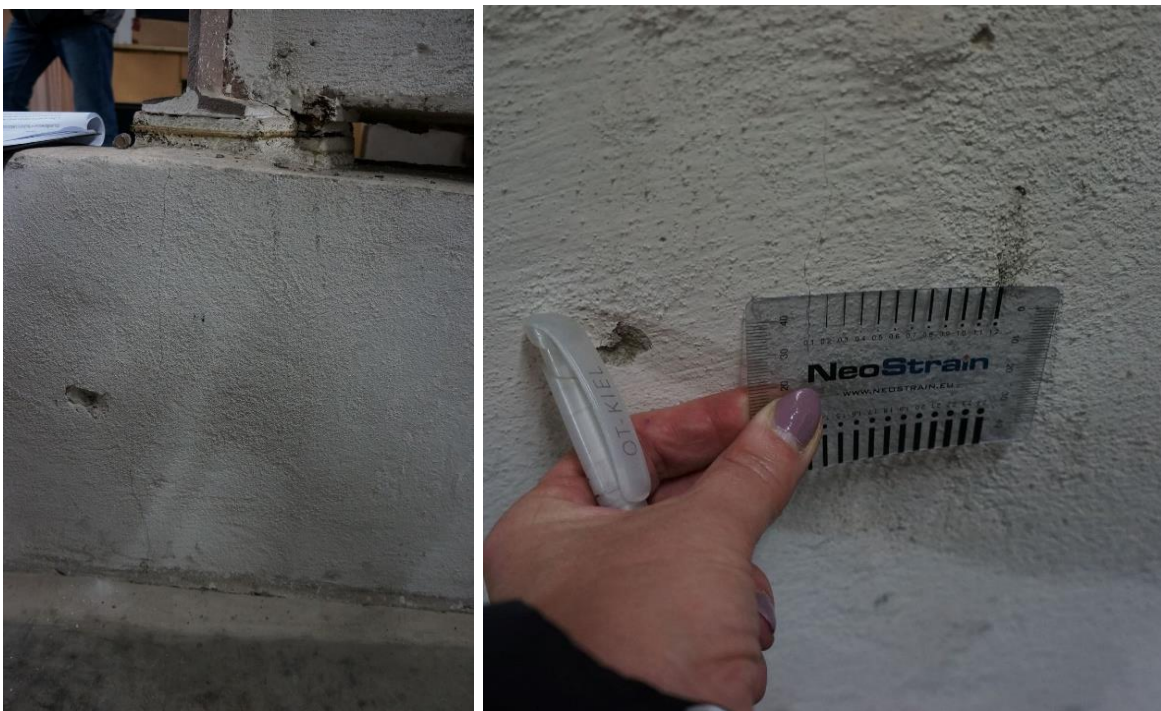
Rysunek 11. Rysy na cokołach jednostek dźwigowych. Szerokość rys 0,1mm oraz tylko jedna rysa może być traktowane jako uszkodzenie nieistotne
