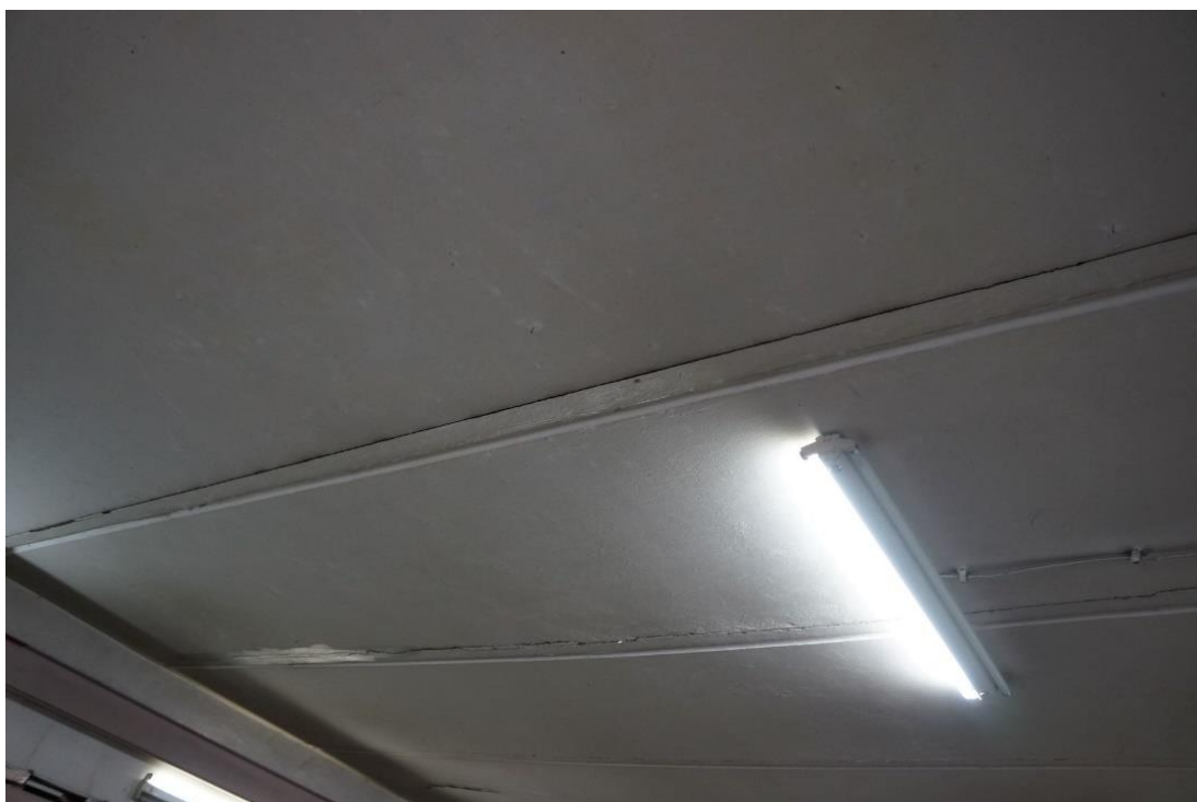
Rysunek 14a,b. Pęknięcia, rysy i odspojenia na stropie maszynowni - brak bezpośredniego wpływu na prace jednostek dźwigowych
