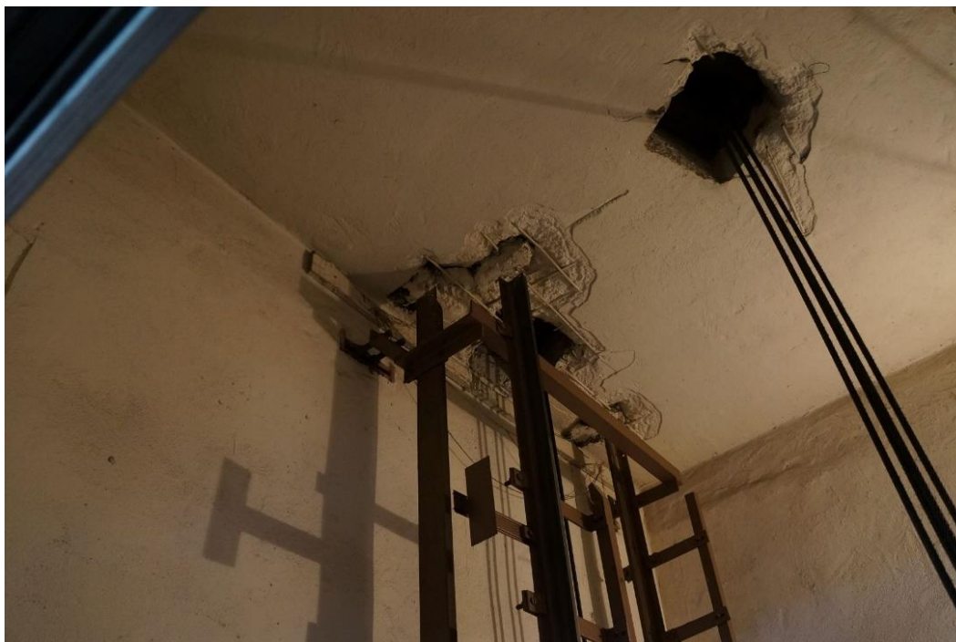
Rysunek 9. Widoczne odkryte zbrojenie #8 narażone na korozję. Uszkodzenia otuliny zbrojenia i braki wypełnień. ,
