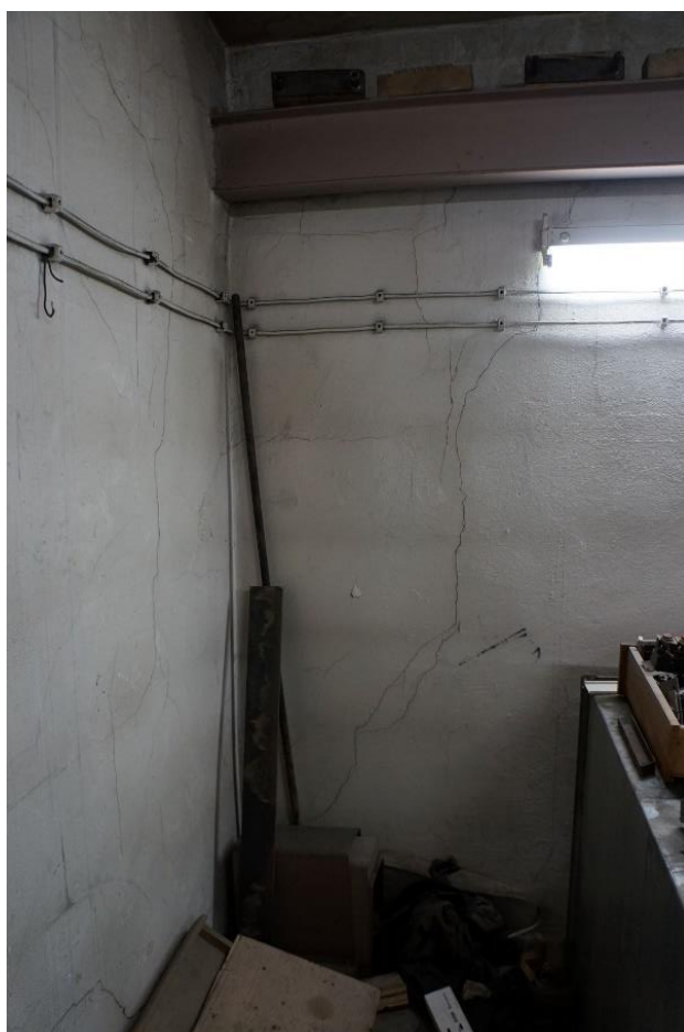
Rysunek 15a,b. Pęknięcia, rysy i odspojenia na ścianach maszynowni - brak bezpośredniego wpływu na prace jednostek dźwigowych
