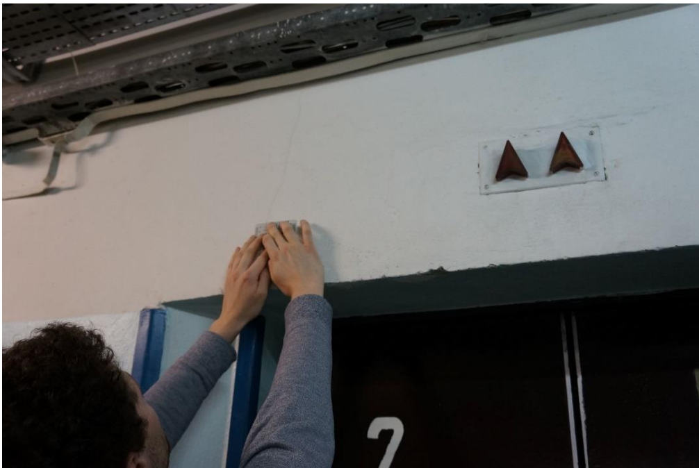
Rysunek 8. Rysy na nadprożu wind 0,2mm- poziom piwnicy
